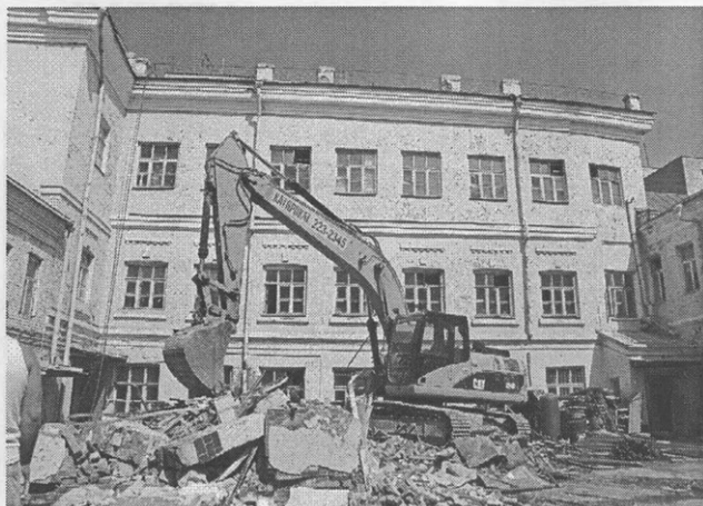
Москва. Незаконный снос усадьбы на улице Бахрушина. 2010 г.
